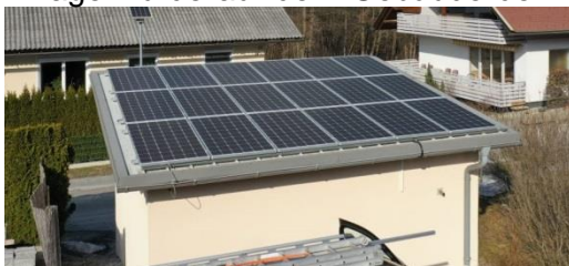
PV-Anlage auf der Pumpstation Techelweg; © Firma Knees
